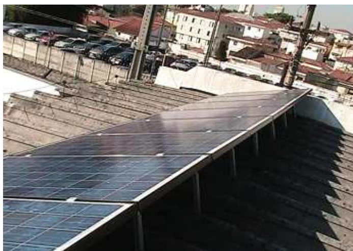
Figura 4: Módulos Fotovoltaicos instalados em Congonhas
