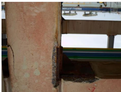
Foto 08 – Fendilhamento no concreto
