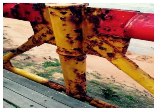
Foto 2 - Corrosão por pites
