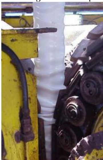
Figura 19: Enrugamento da capa externa
