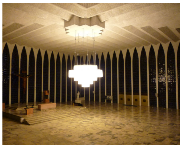
Figura 11: Vista interna da edificação – sobrecarga de utilização forro e lustre. Fonte: acervo do SDB.
