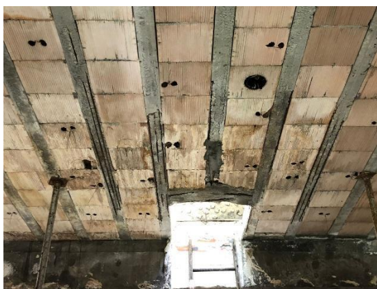
Figura 3 - Corrosão das armaduras de aço e desagregação do concreto em laje
