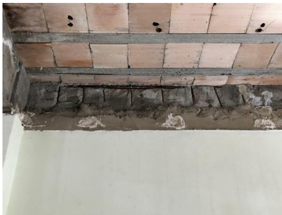
Figura 2 - Corrosão das armaduras de aço e desagregação do concreto em viga
