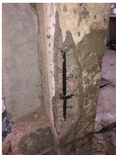
Figura 1 - Corrosão das armaduras de aço e desagregação do concreto em pilar
