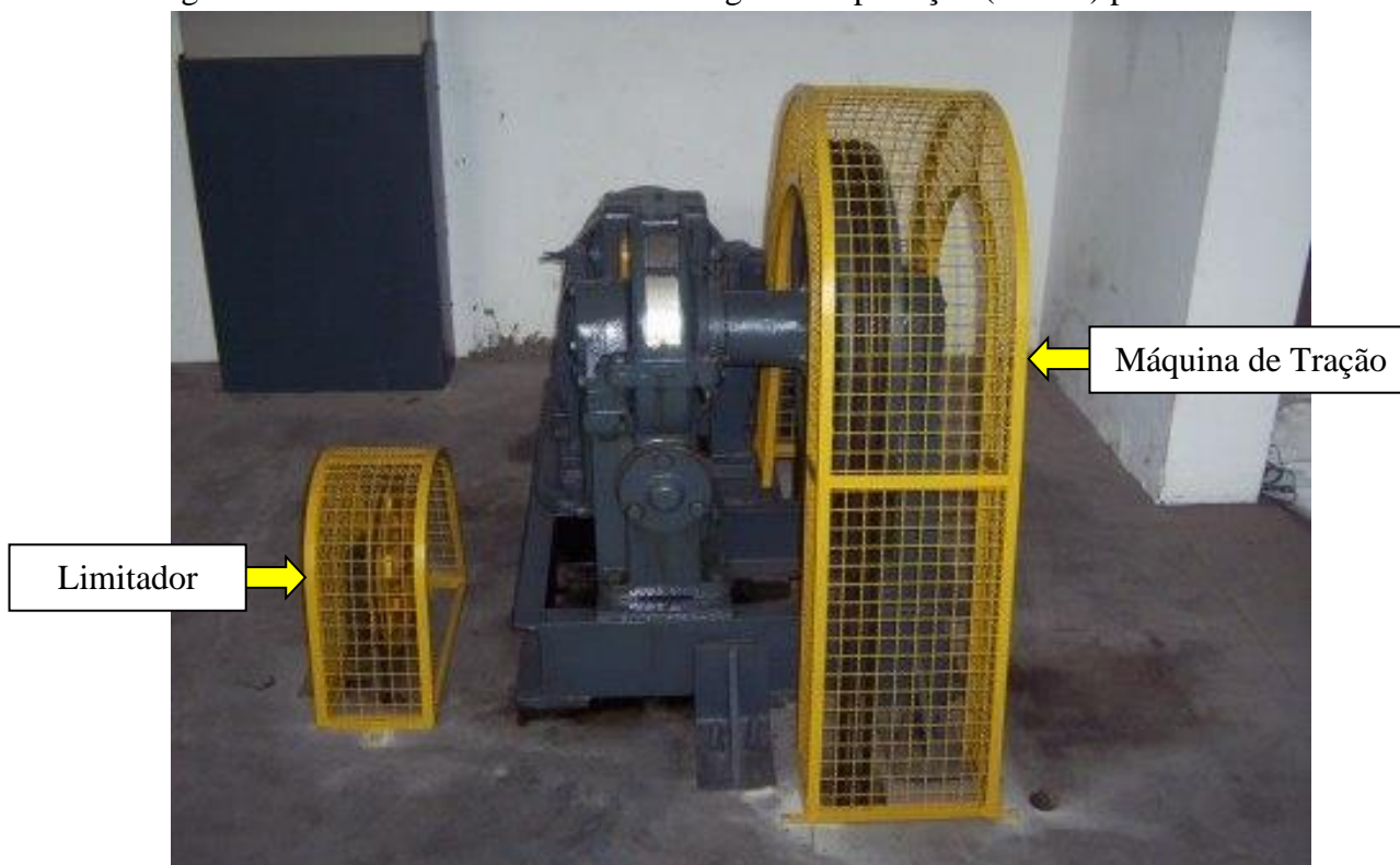
Figura 3 – Limitador de velocidade com grade de proteção (NR-12) para elevadores
